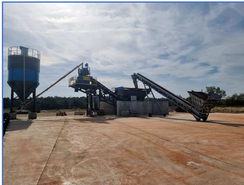
Bauxit maradványt felhasználó betonkeverő telep
